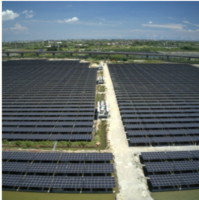
臺南北門 - 地面型 + 特高壓案場
