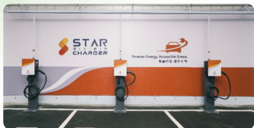
台南台糖沙崙智慧住宅 7kW*2 樁、30kW*2 樁
